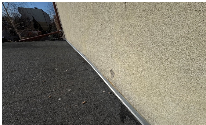
Wgniecenie na elewacji budynku szkoły
